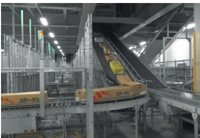
自動搬送設備
